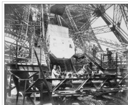
Un des ascenseurs Roux, Combaluzier et Lepape qui occupaient les piliers est et ouest.
